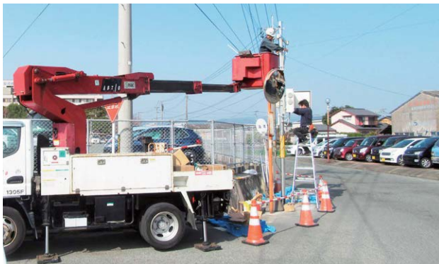
街頭防犯カメラ設置写真
