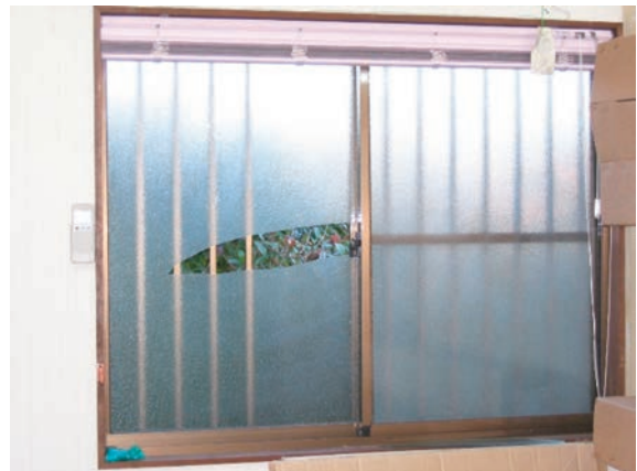
面格子をバールで破壊し、三角割りでガラスを破壊し、侵入された実際の写真
