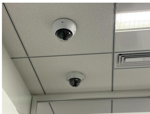
<メールルーム内の監視カメラ>
